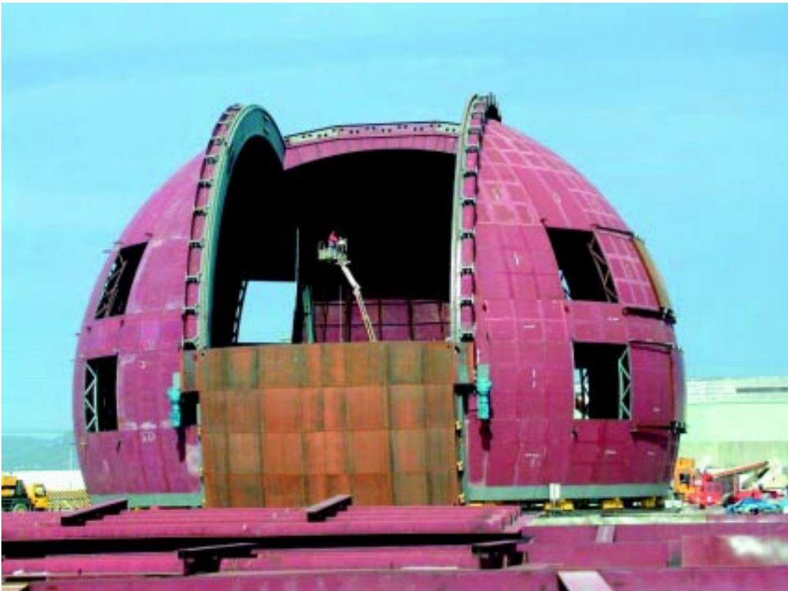
Vista general (marzo 2001) de la cúpula del GTC montada para pruebas en la factoría de URSSA, en Vitoria (España). El proceso de montaje y el funcionamiento de la cúpula ha sido probado en factoría para optimizar su montaje final en el Observatorio del Roque de los Muchachos, en la isla de La Palma.
