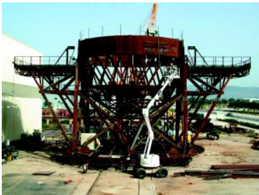
Vista general (julio 2001) de la estructura mecánica del telescopio que se está fabricando y montando en la factoría de Shwartz-Hautmont, en Tarragona (España). El funcionamiento de esta estructura será probado entre los meses de septiembre y octubre de este año 2001. La experiencia del montaje en factoría simplificará el montaje final en el Observatorio.
