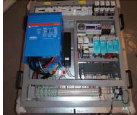
Cuadro eléctrico del control de alta disponibilidad, dotado de controlador programable, inversor, protecciones rearmables, etc.
