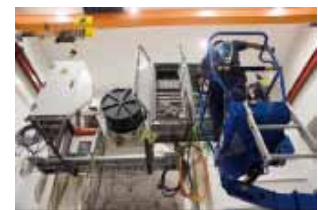
Figura 5: Izquierda: MFI integrado en el QT-1. Derecha: instalación de los armarios de electrónica. En el QT-1.
