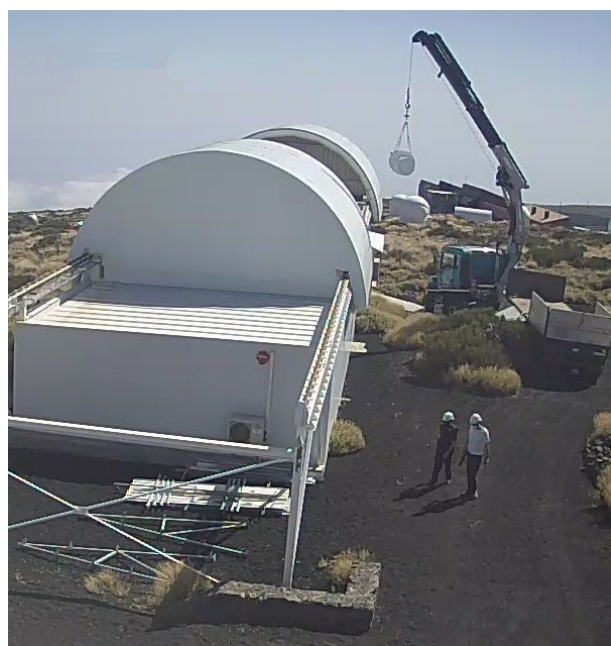
Instalación del Instrumento FTGI en el QT2.
