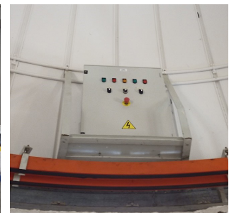
Fig. 2 Nuevo controlador "Esclavo".
